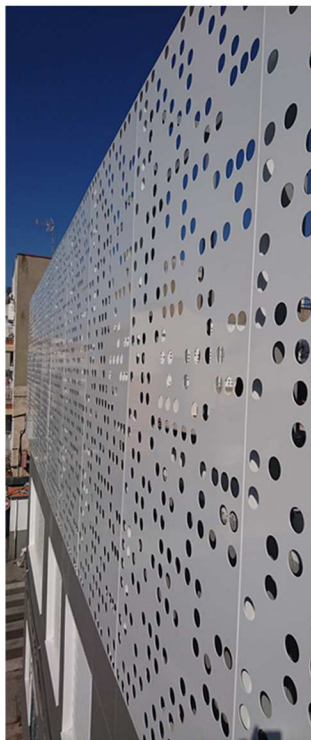
Bandejas acero galvanizado. Perforación aleatoria.
